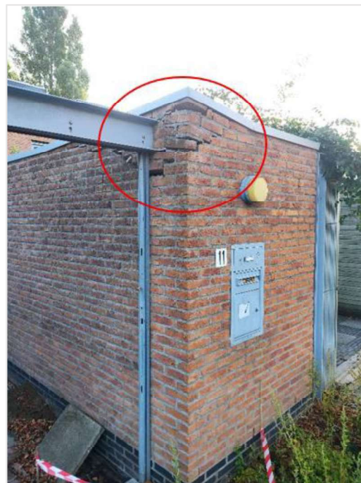
Afbeelding 7. Schade aan metselwerk door het ontstaan van hoogteverschil tussen de balk en het schuurtje. Huisnummer 11, Heivlinder. Boomnummer 1963309.
