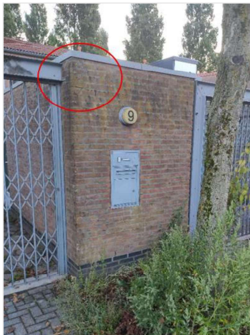
Afbeelding 9. Ruimte tussen de voegen ter hoogte van de dwarsbalk. Huisnummer 9, Donsvlinder. Boomnummer 1938629.
