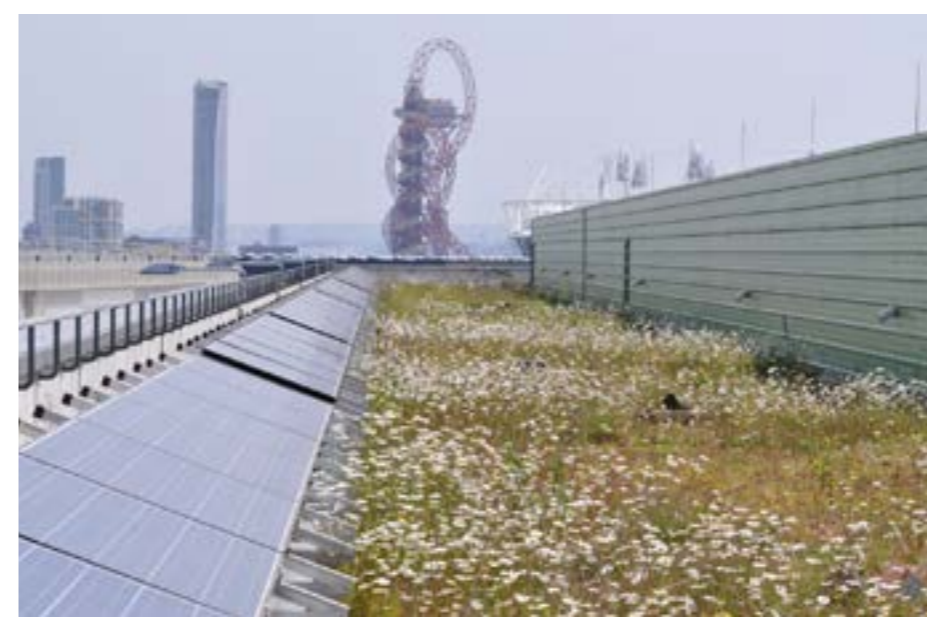
Groen dak geïnstalleerd met zonnepanelen en installaties.
